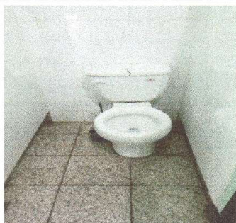
Foto: 5 SERVICIOS SANITARIOS Y SUS ACCESORIOS
